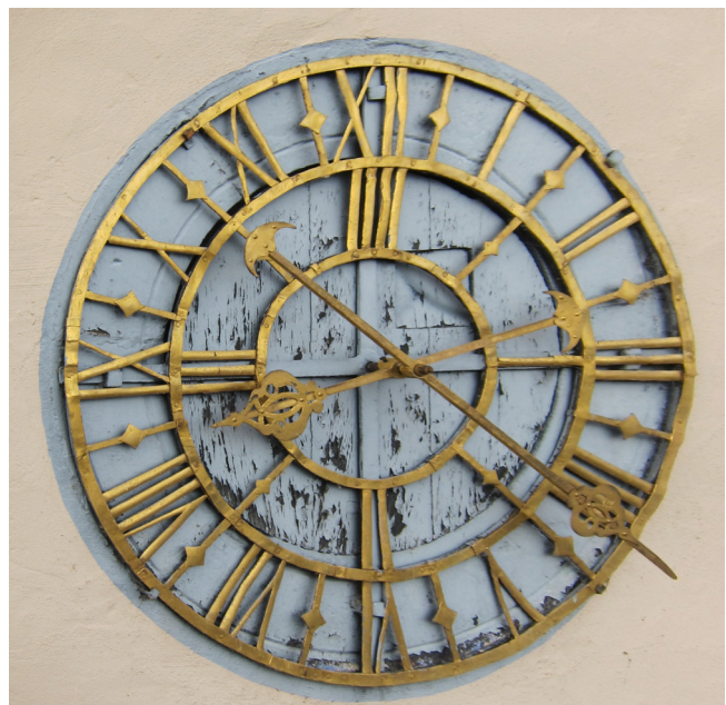
Abb. 10 Vorzustand Uhr Nr. 02 (Nordseite) Turmuhr am Rathaus Ettlingen, KA
