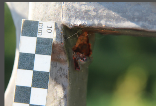
Abb. 6 Dokumentation von Beschichtungsschäden
