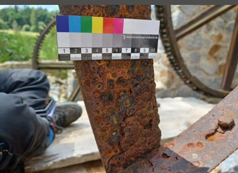
Abb. 2 Dokumentation von Korrosionsschäden
